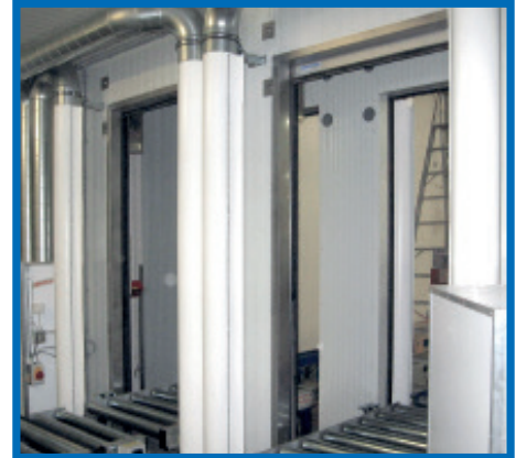
Tiefkühl-Tor zum inertisierten Bereich
